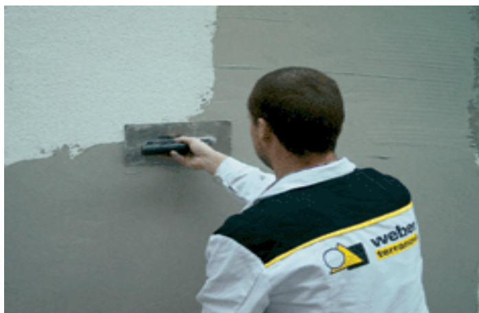
Obrázok 26 Návrh na úpravu steny pri vstupe z bočnej strany školy (Zdroj: http://www.asb.sk/stavebnictvo/konstrukcie-a-prvky/etics/chyby-pri-navrh-arealizacii-tepelnoizolacnych-systemov )
